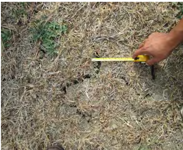
Figura 2. Grietas que aparecen en la superficie.
